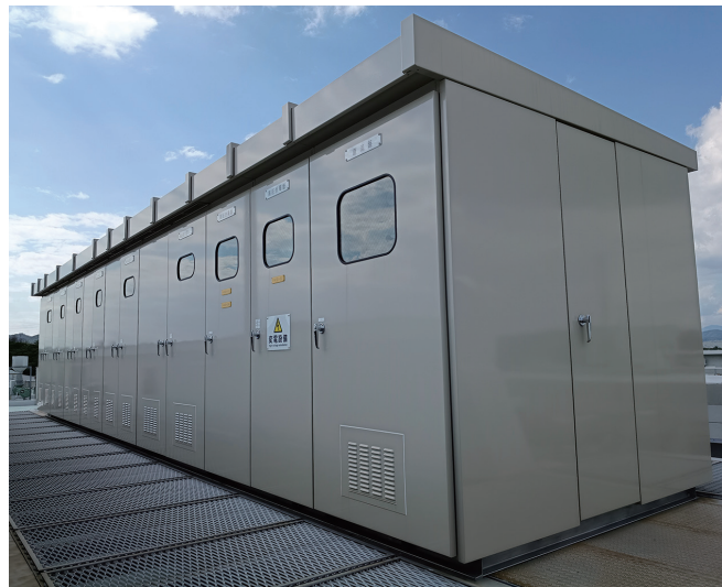
物理科学研究棟受変電設備
