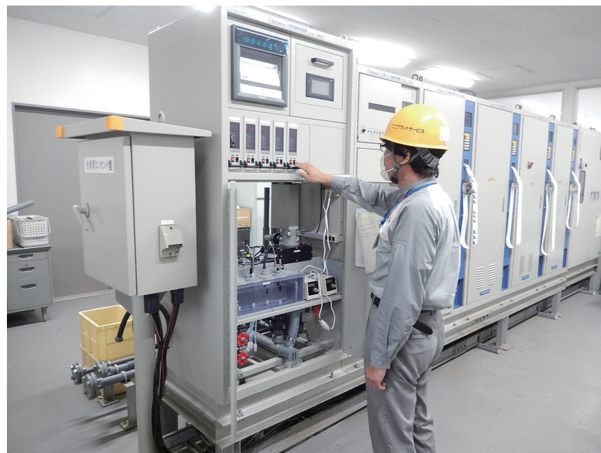
水質自動監視装置
